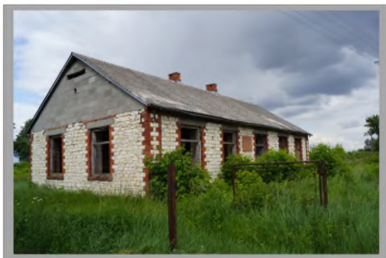
Budynek szkoły w Mszadli Nowej w całkowitej ruinie
